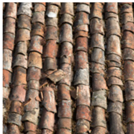
Deterioramento del manto di copertura
